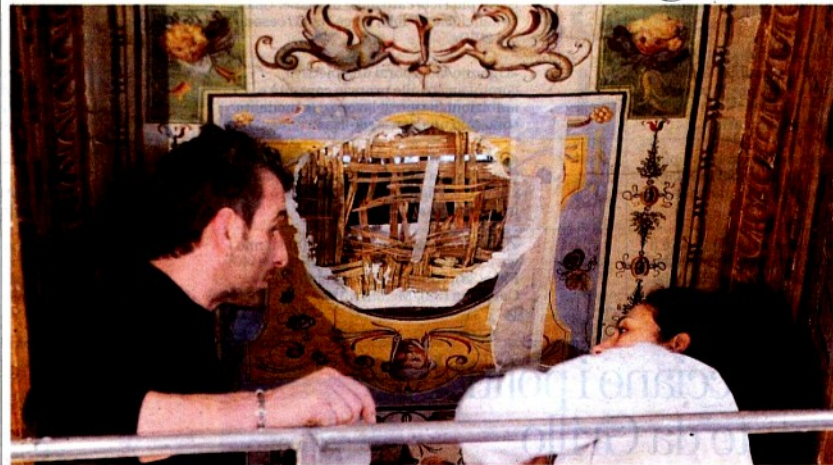
Il pezzo dell'affresco del '500 che si è staccato dal soffitto di un corridoio nella Galleria degli Uffizi a Firenze
