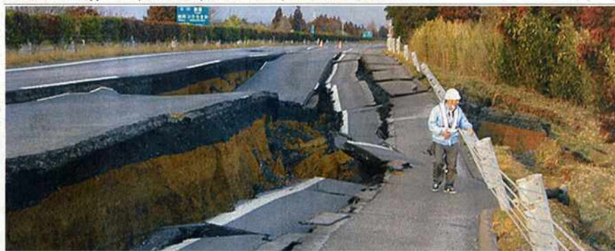
Catastrofe. Su infrastrutture ed energia le ripercussioni più pesanti dopo il disastro che ha colpito il Giappone (nella foto, un tratto di autostrada nei pressi di Mito)
